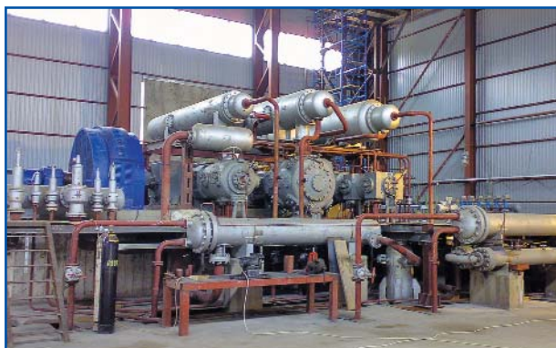
Фото 2. Компрессор 6ВМ16-150/200 выпуска 2006 г. на Новороссийском кислородном заводе
