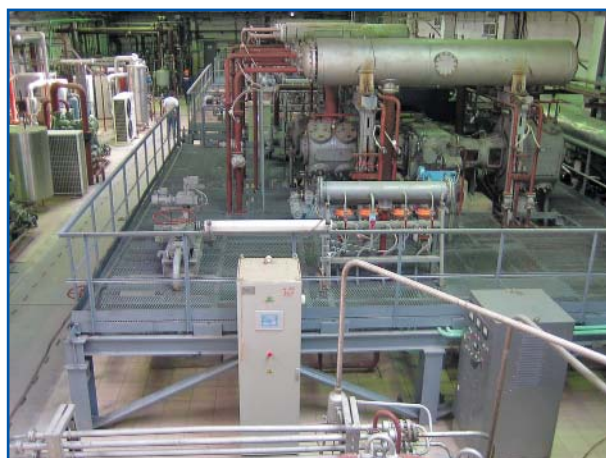
Фото 4. Компрессор 4ВМ10-55/71 с площадкой обслуживания на литейно-прокатном заводе в г. Ярцево Смоленской области
