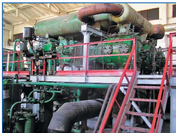
Фото 1. Внешний вид компрессора 6ВМ16-140/200М1, работающего в составе ВРУ на «Харьковском автогенном заводе» (год выпуска — 1989)
