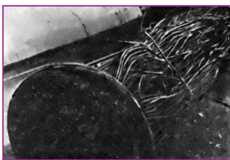
Фото 3. Конденсатор-испаритель с внутритрубным кипением, повреждённый несколькими взрывами
